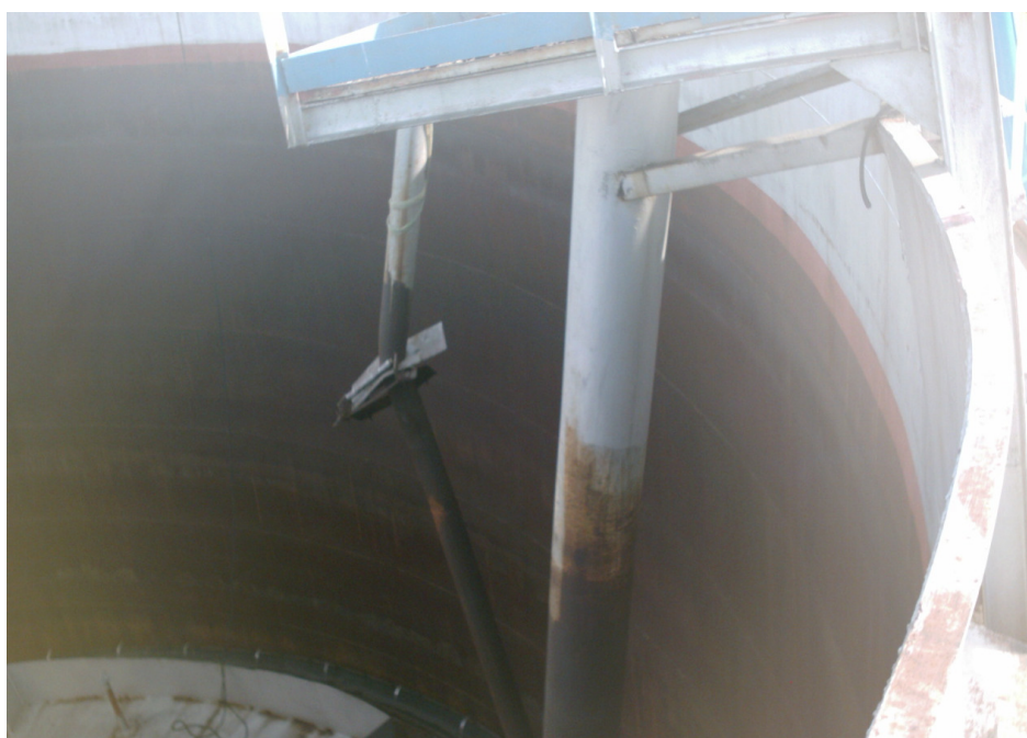
Fig. 5 – Manta deformată în zona dispozitivului antirotativ
