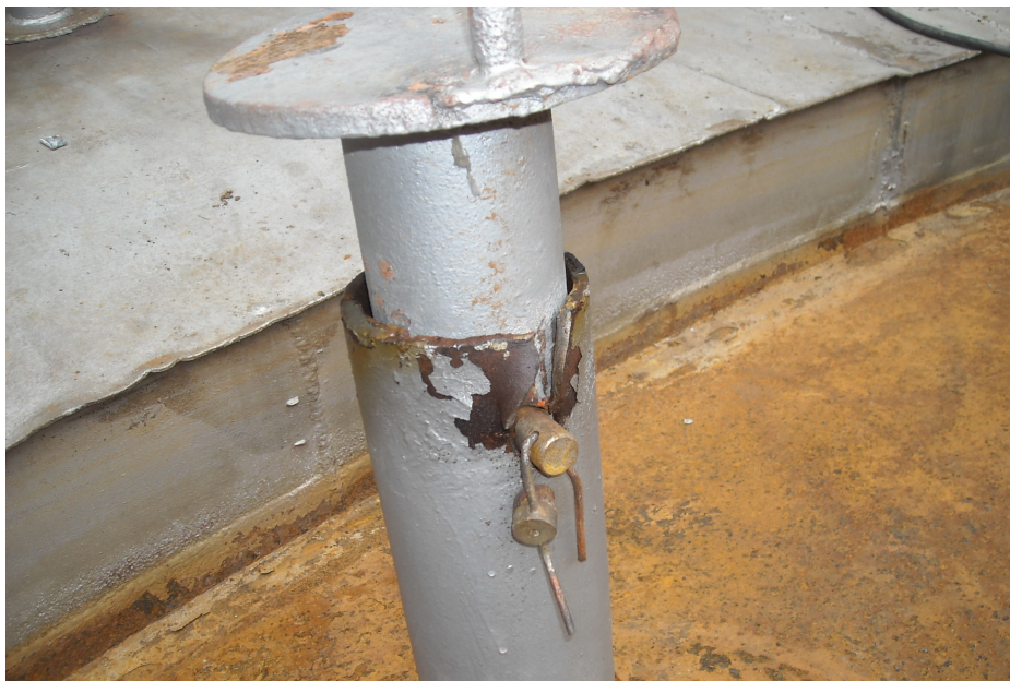
Fig. 4b – Picior deteriorat la exterior
