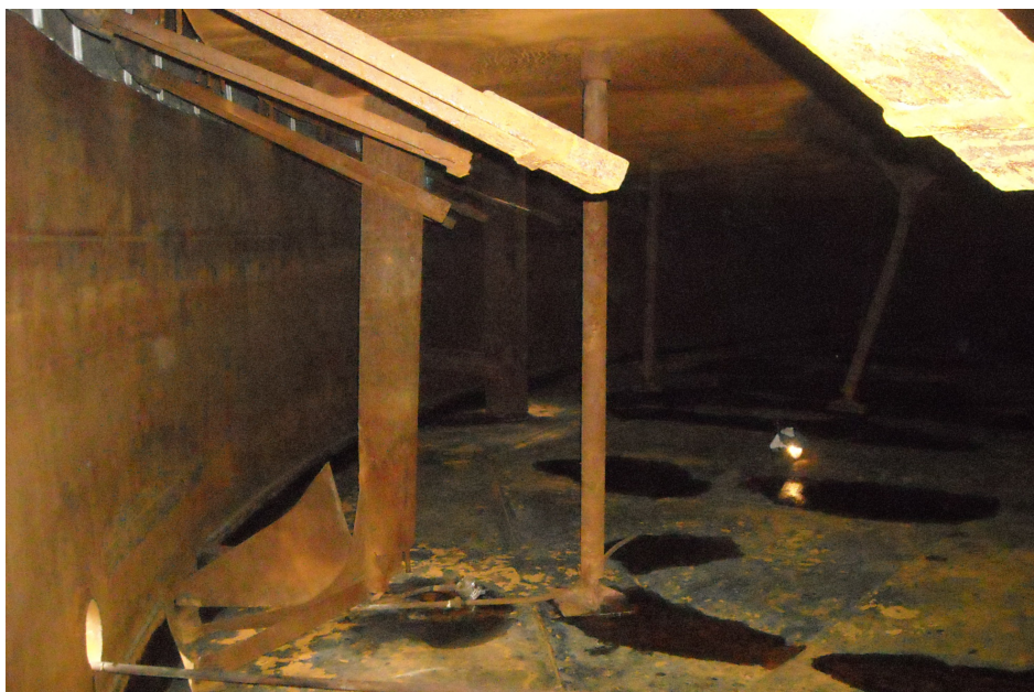
Fig. 3 – Placa de fund a dispozitivului antirotativ deteriorată
